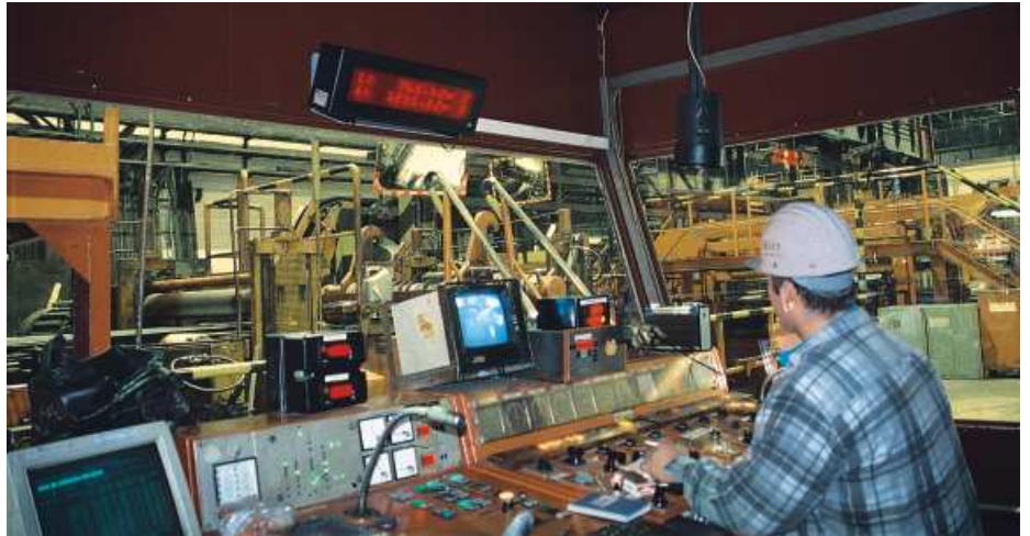
Steuerstand in der Bandanlage der Salzgitter AG
